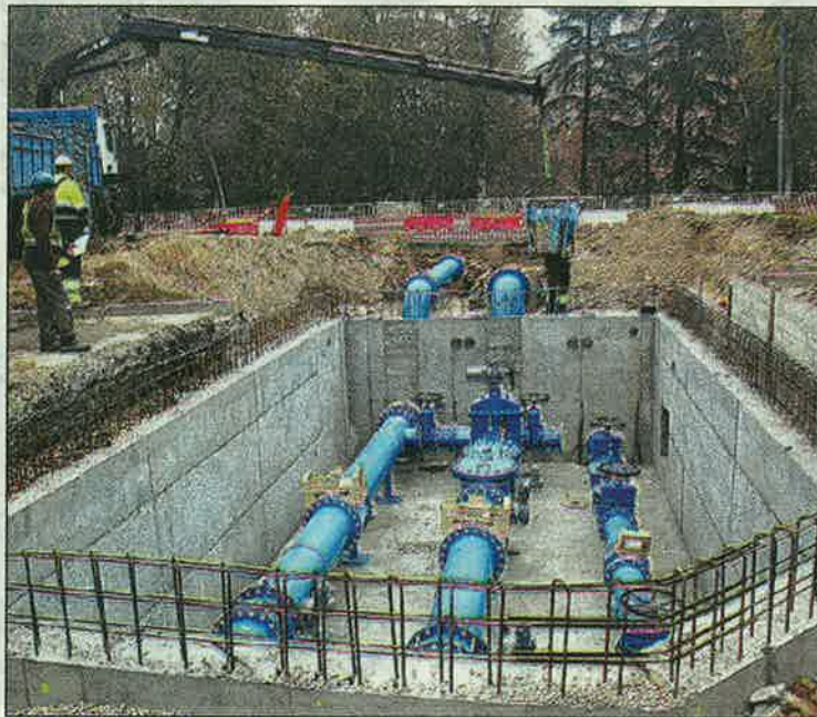
FOTO: Selena García / Una gran arqueta subterránea de distribución
