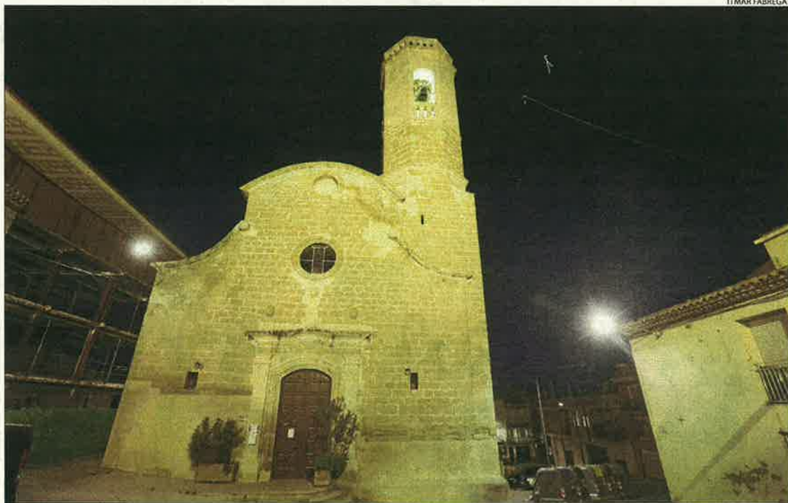
L'església d'Alpicat que ahir es va tancar al públic per desprendiments a la nau central.
